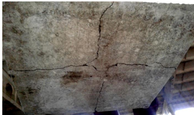
Рис. 3. Вигляд плит після руйнування: а) плита марки ПК-1.1; б) плита марки ПК-2.2
