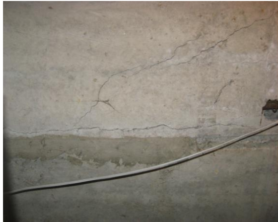
Рис. 3. Тріщини у плитах перекриття над підвалом
