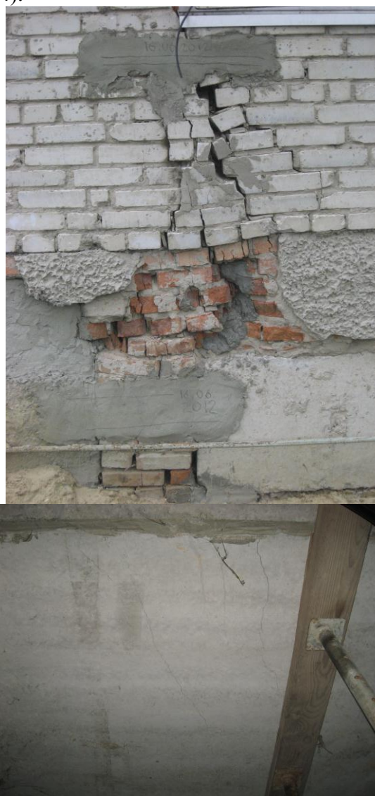
Рис. 2. Тріщини в несучій зовнішній стіні будівлі
