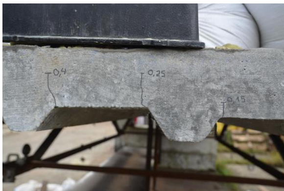
Рис. 4. Тріщини в плиті (КСБ-3).
