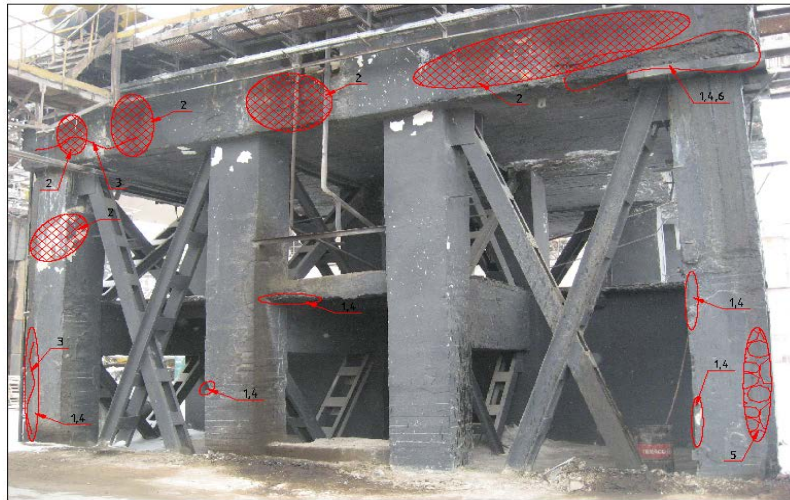
Рис. 3. Дефекти і пошкодження опори П6/О4: 1 – сколення бетону; 2 – корозія та руйнування бетону; 3 – тріщини; 4 – оголене (корозія) арматури; 5 – відшарування (руйнування) бетону; 6 – пори, раковини бетону.
