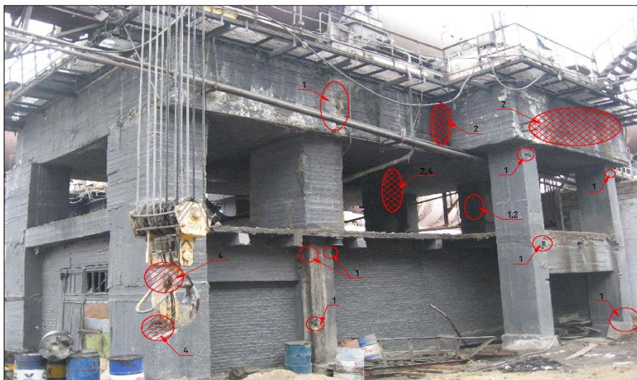
Рис. 4. Дефекти і пошкодження опори П5/О4: 1 – сколення бетону; 2 – корозія та руйнування бетону; 3 – тріщини; 4 – оголення (корозія) арматури.
