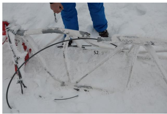
Рис. 14. Деформації і розрив труби в секції 52
