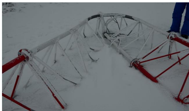
Рис. 8. Згин щогли в місці з'єднання секції 10-ї та 11-ї
