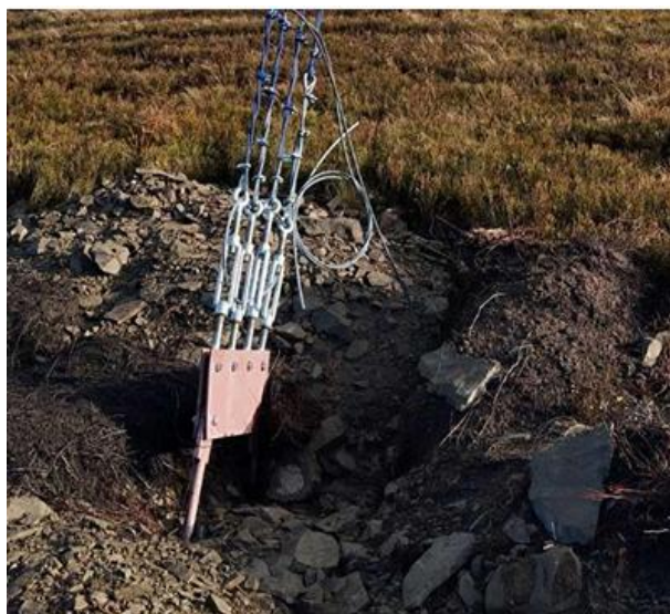
Рис. 3. Загальний вигляд анкерного кріплення відтяжок метеощогли
